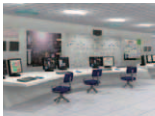
大型火力発電所 中央操作室
